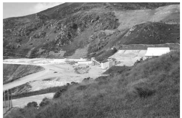
Photo 8. Site du concasseur primaire et plate-forme de départ du téléphérique (cliché Gérard Sustrac).
